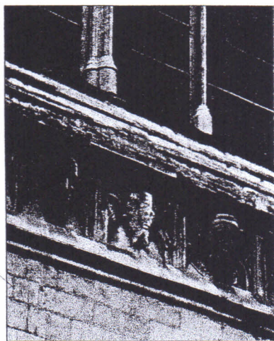
La « maladie de la pierre » subie par certains monuments. Rongé par les pluies acides, le calcaire ( \text{CaCO}_3 ) se transforme en sulfate de calcium.
